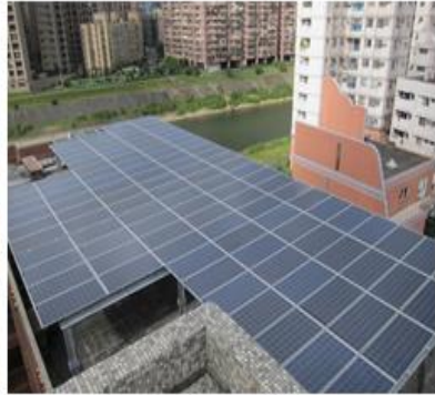
樟樹國中 249.09kWp
